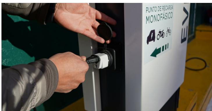
Foto: Punto de recarga monofásico (Foto DELAPAZ)
